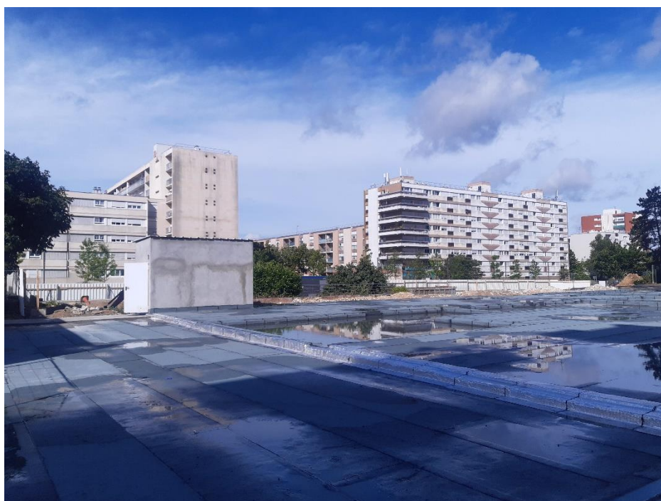
Photographies de la partie supérieure de la dalle – Juin 2021.
